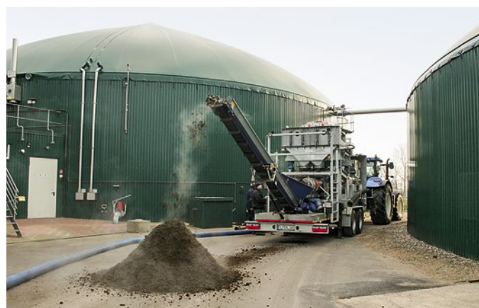
Die Silcon-Separationsanlage mit Pressschnecke hat dank eines vorgeschalteten Vakuum-Vibrationsiebs eine hohe Durchsatzleistung.
